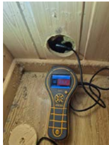
Målt høye fuktverdier i innforet vegg.
