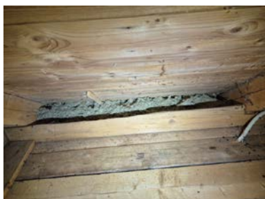
Ingen lufting i nedre del.
