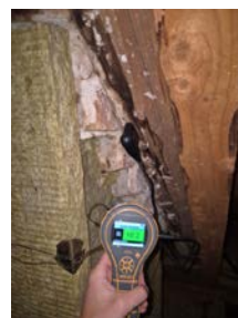
Ingen unormal fukt målt ved eldre fuktmerker rundt pipe.
