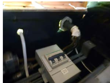
Kabelinnføringer til sikringsskap er ikke tette. (TG 3)
