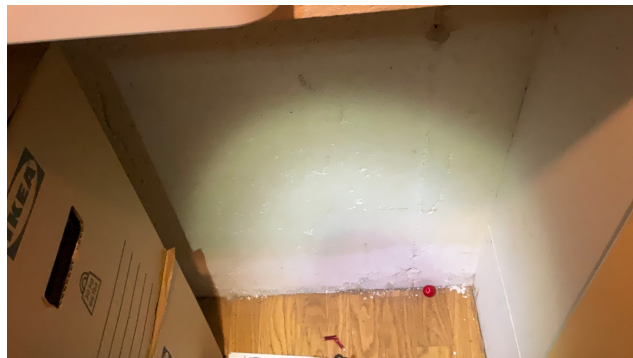
Saltutslag i nedre del av synlige murvegger.
