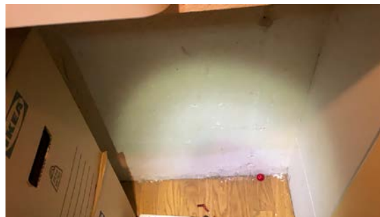
Saltutslag i nedre del av synlige murvegger.
