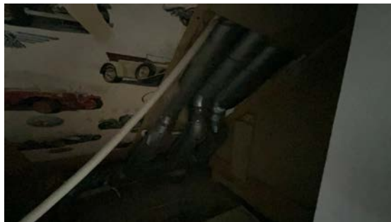
Ventilasjonsrør ført opp i isolasjonen uten tetting mot diffusjonssperren
