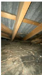
Fuktmerker og eldre tekking av eternitt.
