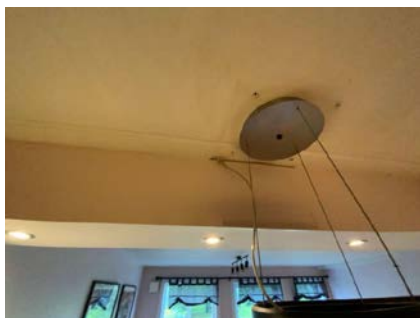
Ledning til ventilator bør utbedres.
