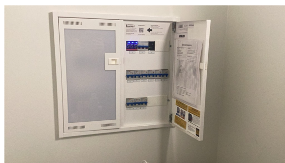
Sikringsskap på bod.
