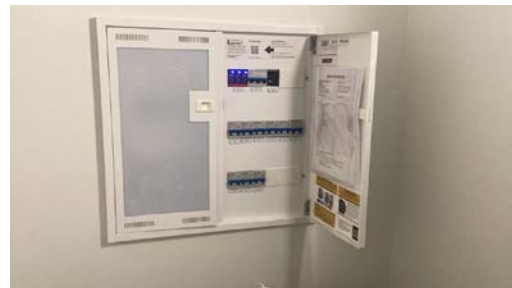
Sikringsskap på bod.
