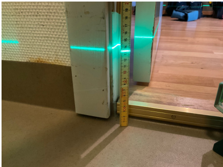
Belegget ved dørterskel
