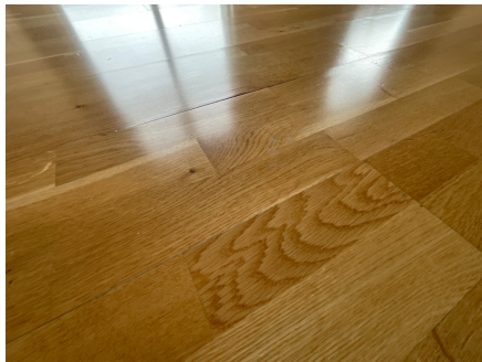
Oppbuling og sprekk på soverom.
