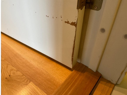
Skader på dørblad inn mot bad.
