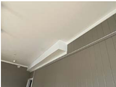
Manglende maling på et mindre området med lampe. mindre oppsprekk på mykfuge mellom innkassing og himling.
