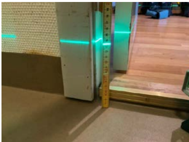
Belegget ved dørterskel
