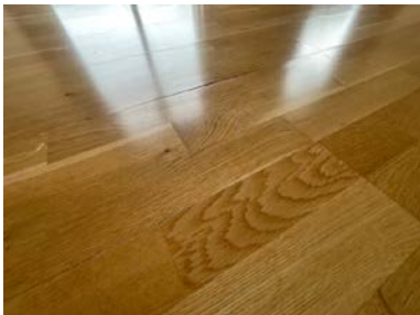
Oppbuling og sprekk på soverom.
