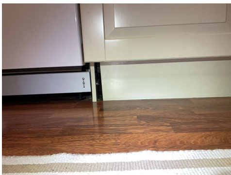
Sokkel mot gulv passer ikke helt.
