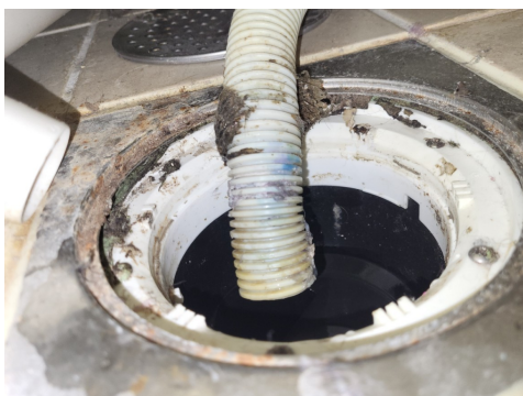
Sluk i gulv under kabinett.
