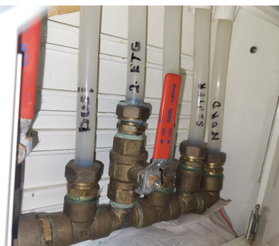
Koblingsskap for vann i kjøkkeninnredning.
