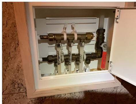
Koblingsskap på bad.
