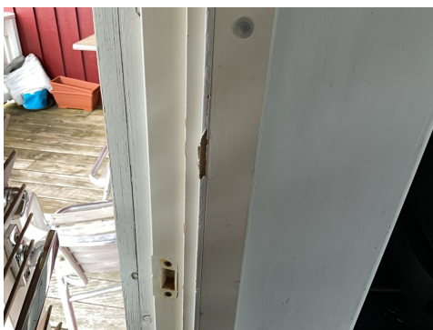
Skade på innvendig karm på terrassedør.
