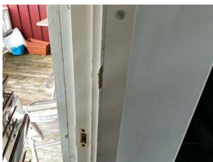
Skade på innvendig karm på terrassedør.
