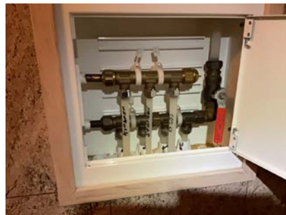
Koblingsskap på bad.
