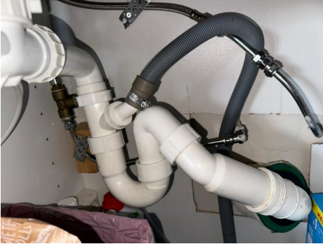
Røropplegg i kjøkkenbenk
