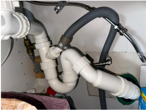
Røropplegg i kjøkkenbenk
