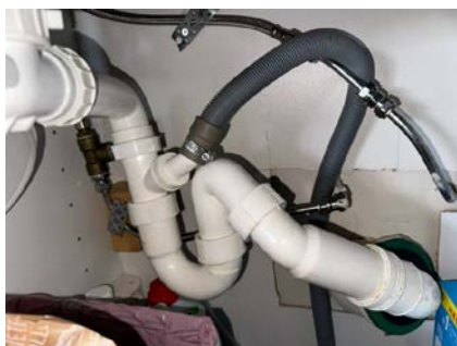
Røropplegg i kjøkkenbenk
