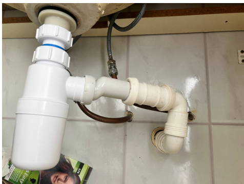
Rørøpplagg under vask på bad i 2.etg
