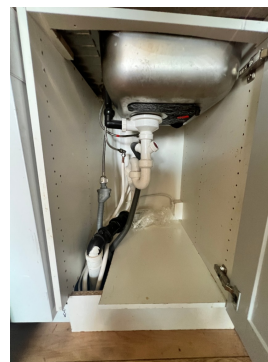
Rørøpplagg under kjøkkenbenk
