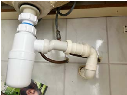
Røropplegg under vask på bad i 2.etg
