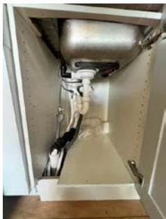
Røropplegg under kjøkkenbenk
