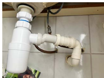
Rørøpplagg under vask på bad i 2.etg
