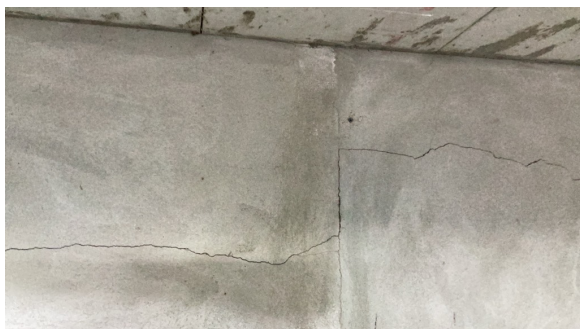
Eksempel på sprekk i garasje.
