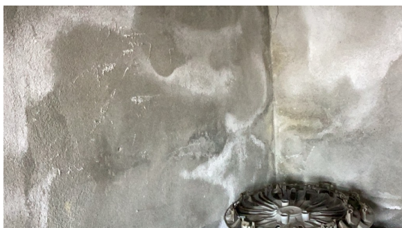
Saltutslag på vegg i garasje.
