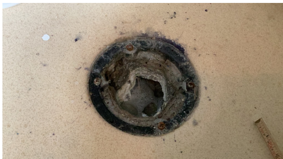
Sluk av plast med klemring.
