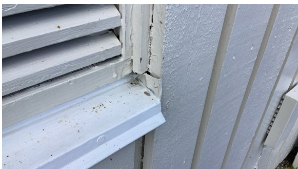
Stedvis utett mellom kledning og beslag
