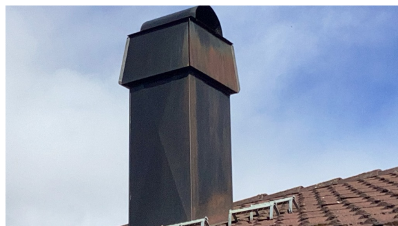
Misfarging på pipebeslag
