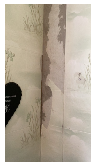
Eksempel på tapet som har løsnet fra vegg
