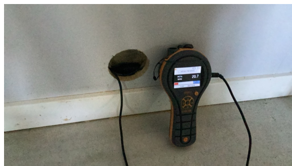
Fuktmåling i vegg i treningsrom.
