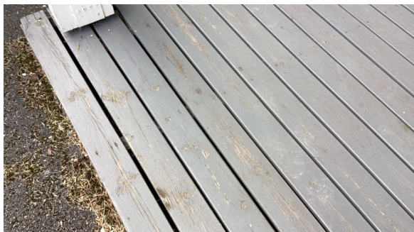
Eksempel på slitasje på terrasse.
