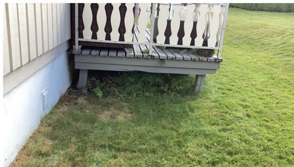
Skjevheter på fundamentering av veranda på bakside.
