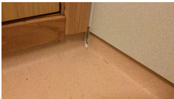
Eksempel på sprekk i veggghjørne.
