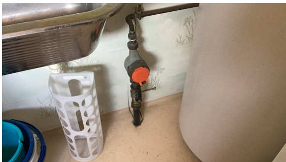
Stoppekran og vannmåler på vaskerom.
