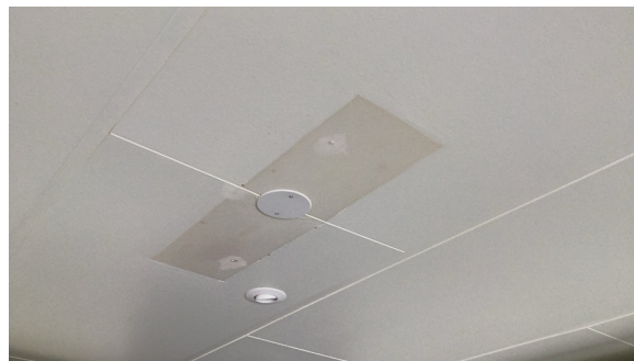
Noen merker i himling på kjøkken.
