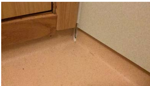
Eksempel på sprekk i vegg hjørne.
