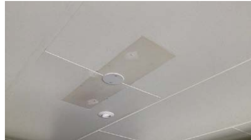
Noen merker i himling på kjøkken.
