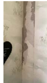
Eksempel på tapet som har løsnet fra vegg
