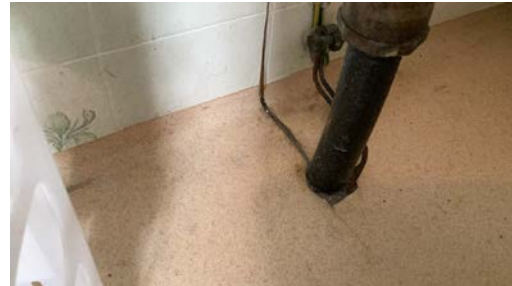
Eksempel på utetthet i gulvbelegg.
