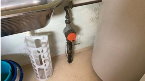
Stoppekran og vannmåler på vaskerom.
