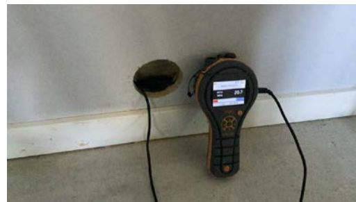
Fuktmåling i vegg i treningsrom.
