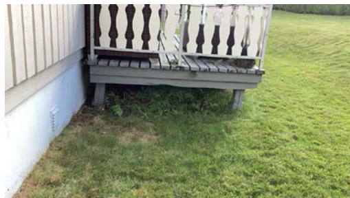
Skjevheter på fundamentering av veranda på bakside.
