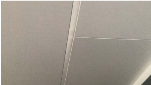
Himlingsplater har løsnet fra innfesting på soverom.
