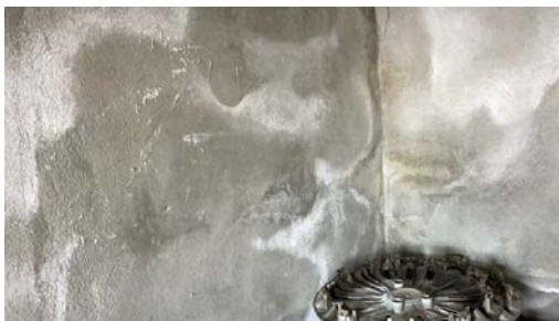
Saltutslag på vegg i garasje.
