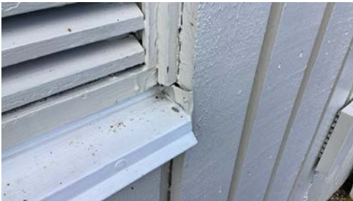
Stedvis utett mellom kledning og beslag
