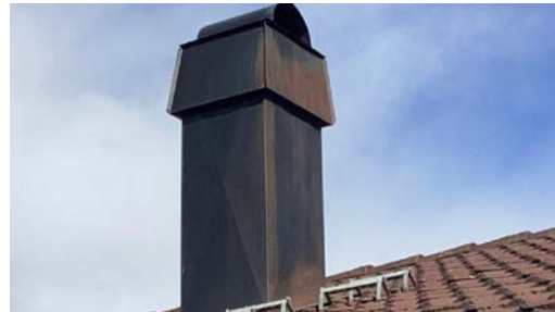
Misfarging på pipebeslag
