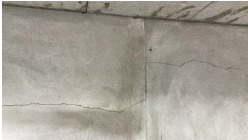
Eksempel på sprekk i garasje.
