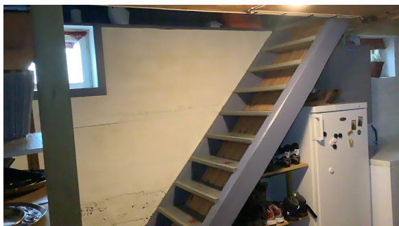
Kjellertrapp mangler rekkverk.
