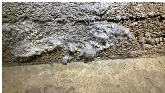
Eksempel på saltutslag.
