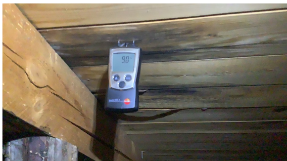
Misfarget taktro inntil pipe, men det måles tørt.
