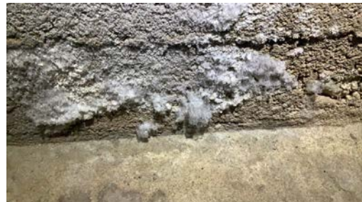
Eksempel på saltutslag.
