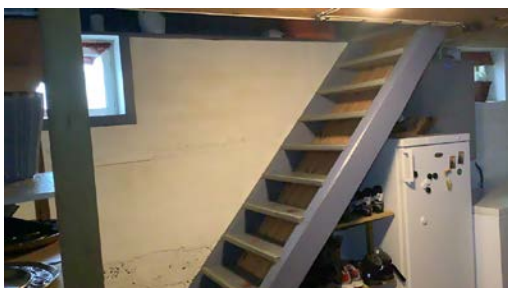
Kjellertrapp mangler rekkverk.
