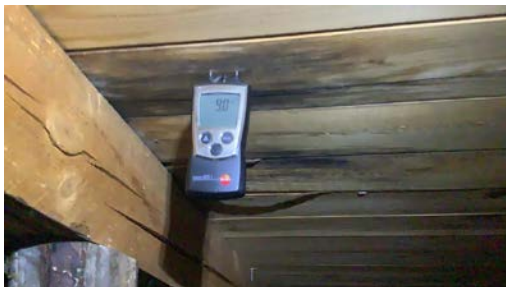
Misfarget taktro inntil pipe, men det måles tørt.
