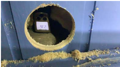
Hulltaking, og det påvises skadelig fuktinnhold i treverk-
