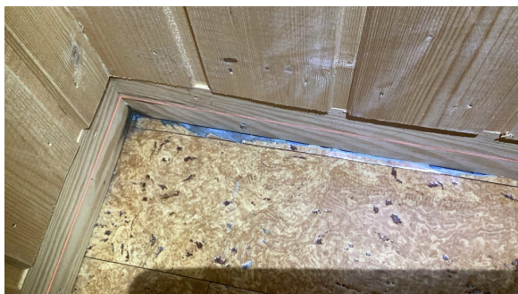
Skade på belegg inntill vegg.
