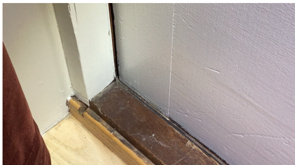
Terrassedør subber i terskel.
