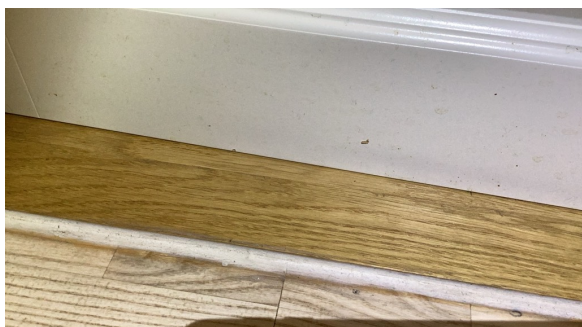
Ett dørbblad til ett soverom tar litt i terskel.
