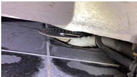
Begrenset tilgang til sluk for inspeksjon.
