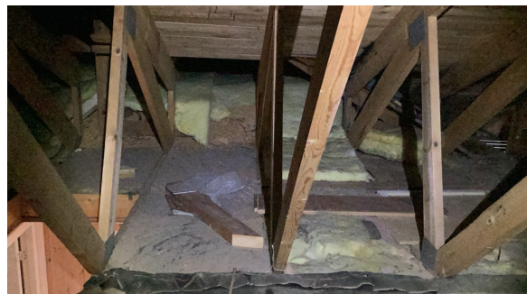
Ujevn isolering enkelte steder.
