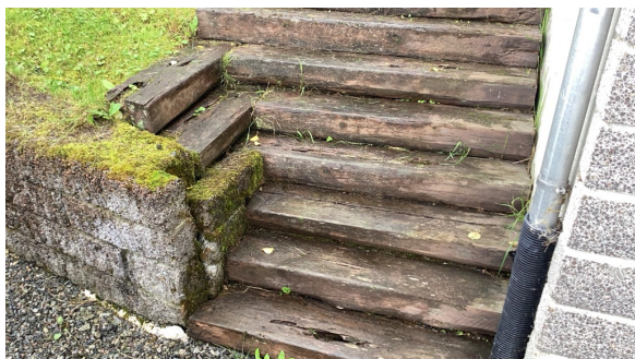
Råte observert i trapp.
