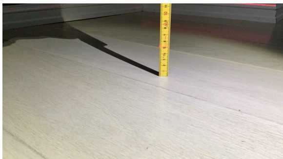
Helningsavvik ble målt til 21 mm innenfor 2 meter på soverom i 1. etasje.
