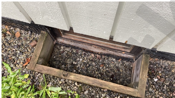
Grunnmursplast mangler avslutningslist enkelte steder.
