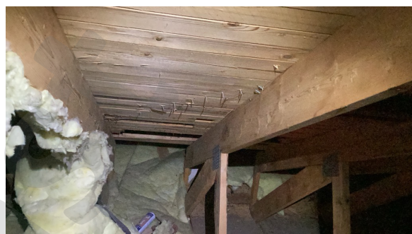
Spiker gjennom undertak enkelte steder.
