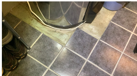
Manglende fliser under varmtvannstank.
