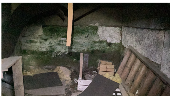
Misfarging på mur.
