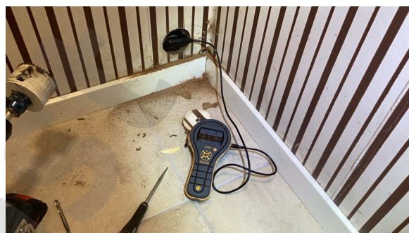
Fuktmåling ble foretatt, jeg målte skadelig fukt.
