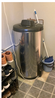
Varmtvannstank på vaskerom i underetasje.
