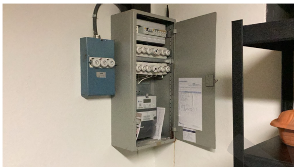
Sikringsskap på bod i underetasje.
