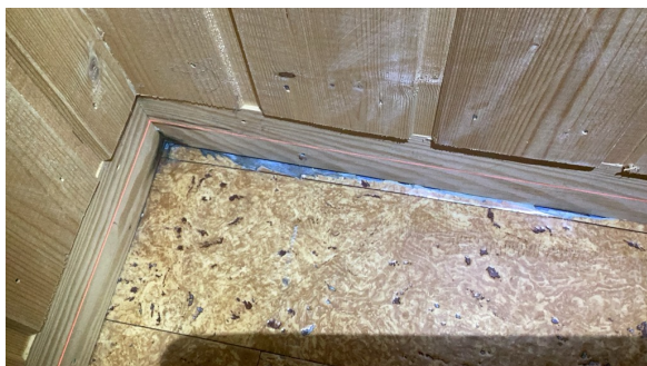
Skade på belegg inntill vegg.
