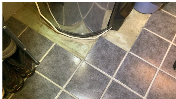
Manglende fliser under varmtvannstank.
