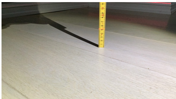
Helningsavvik ble målt til 21 mm innenfor 2 meter på soverom i 1. etasje.
