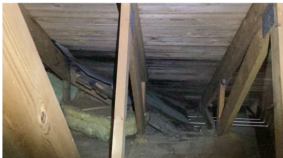
Misfarging på undertak.
