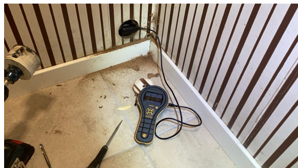
Fuktmåling ble foretatt, jeg målte skadelig fukt.
