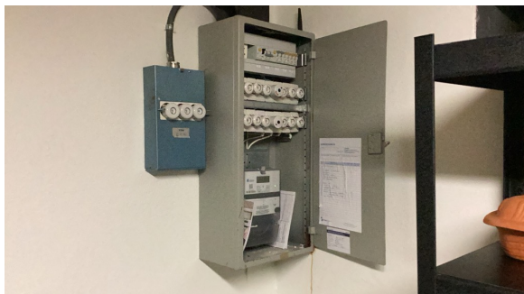
Sikringsskap på bod i underetasje.
