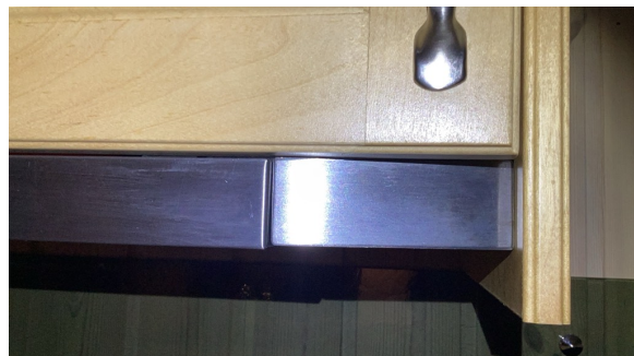
Skapdør over ventilator må justeres litt.
