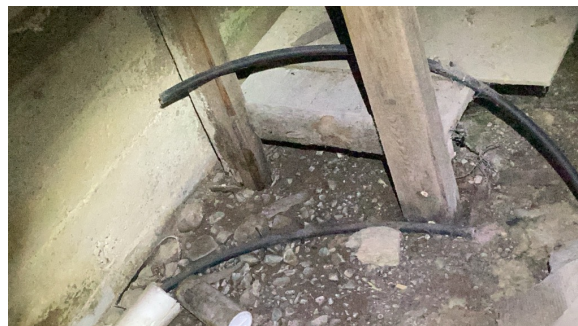
Råte observert på trevirke.
