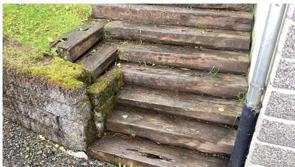
Råte observert i trapp.
