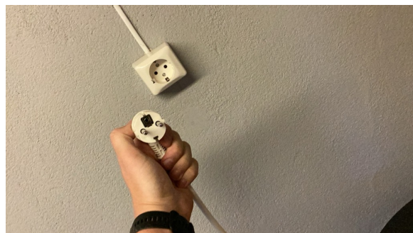
Sjekk av støpsel.
