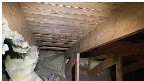
Spiker gjennom undertak enkelte steder.
