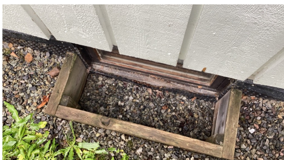
Grunnmursplast mangler avslutningslist enkelte steder.
