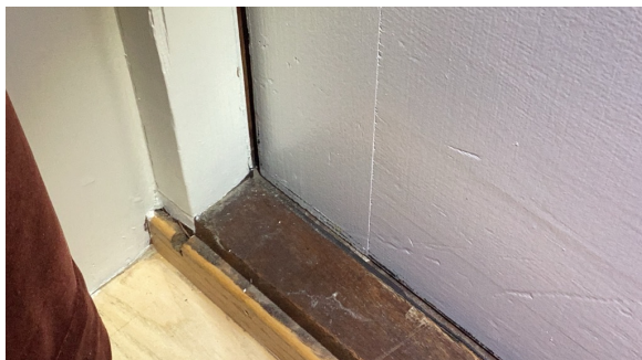
Terrassedør subber i terskel.
