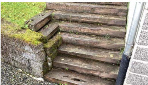
Råte observert i trapp.
