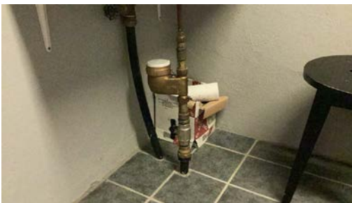
Vannmåler og stoppekran på vaskerom.
