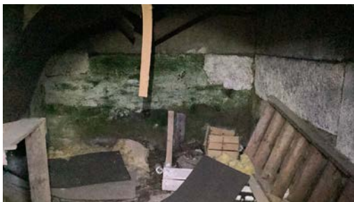
Misfarging på mur.
