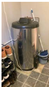
Varmtvannstank på vaskerom i underetasje.
