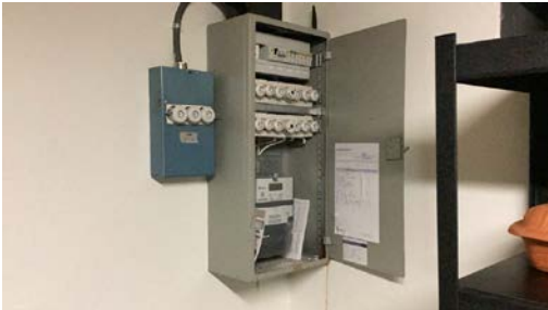
Sikringsskap på bod i underetasje.
