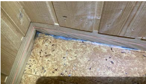
Skade på belegg inntill vegg.
