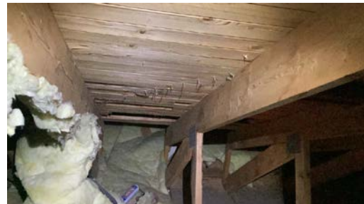
Spiker gjennom undertak enkelte steder.
