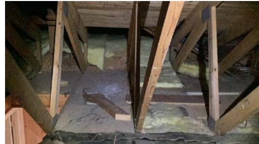
Ujevn isolering enkelte steder.
