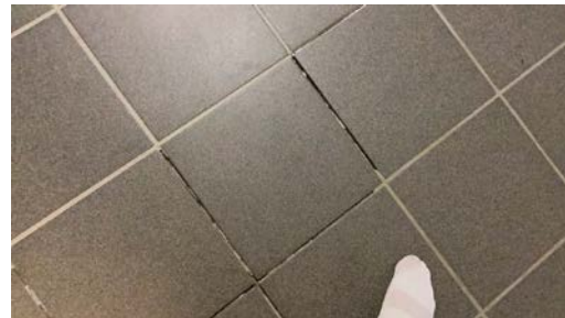
Mangler fuge rundt enkelte fliser på bod i underetasje.
