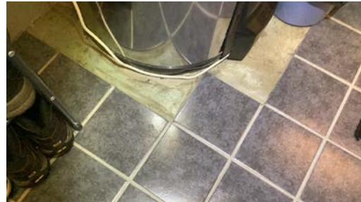
Manglende fliser under varmtvannstank.
