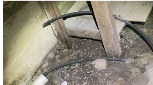
Råte observert på trevirke.
