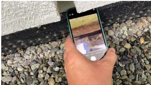
Sjekk av lufting.
