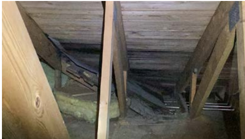
Misfarging på undertak.
