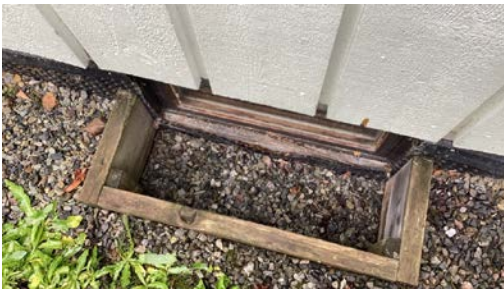
Grunnmursplast mangler avslutningslist enkelte steder.
