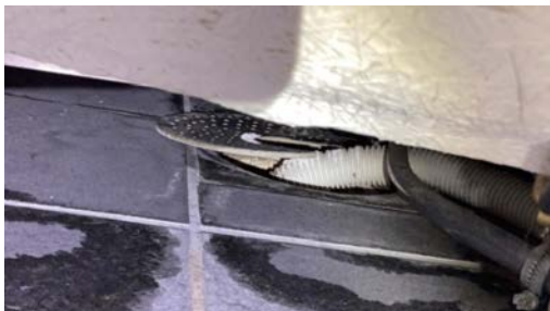
Begrenset tilgang til sluk for inspeksjon.
