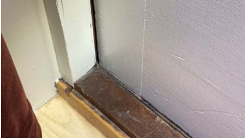
Terrassedør subber i terskel.
