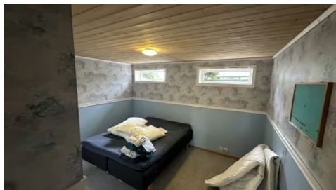
Kontor og hobbyrom i underetasjen mangler ventilering, fare for at et oppstår skader ved bruksendring. Tg:3.
