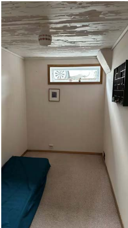
Kontor og hobbyrom i underetasjen mangler ventilering, fare for at et oppstår skader ved bruksendring. Tg:3.
