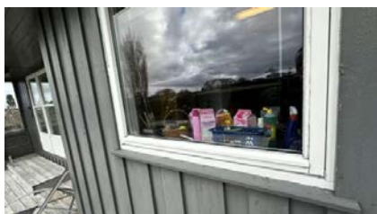
-Råte/fukt registrert i vindu/vindusforinger på vaskerom, samt terrasse dør øst. Tg:3.
