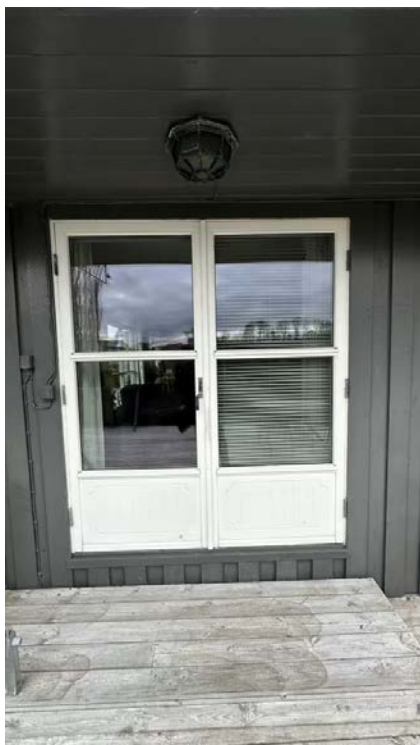
-Råte/fukt registrert i vindu/vindusforinger på vaskerom, samt terrasse dør øst. Tg:3.
