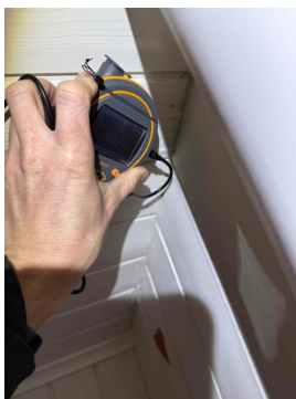
Bildet viser indikasjon på fukt ved lufterøret på toalettrommet.
