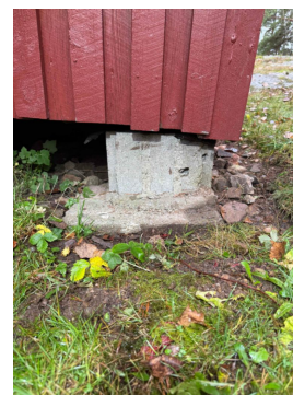
Bildet viser fundamentet til boden med skjevheter.
