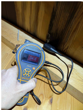
Bildet viser fukt i undertak i boden.
