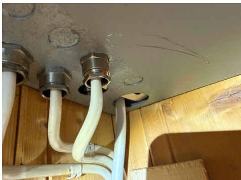
Bildet viser utette gjennomføring, manglende gjennomføringer.
