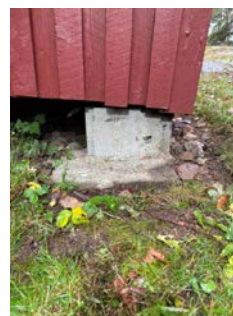
Bildet viser fundamentet til boden med skjevheter.
