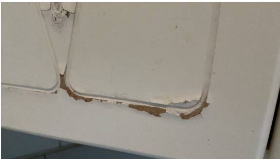
Fuktskader på skapdører
