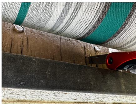
Råteskade i kledning
