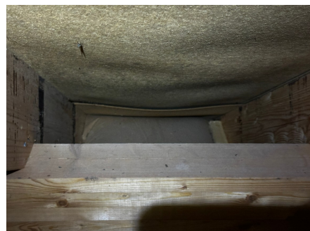
Isolasjon ligger opptil undertak
