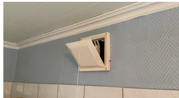
Veggventilen er koblet til elektrisk styrt vifte.
