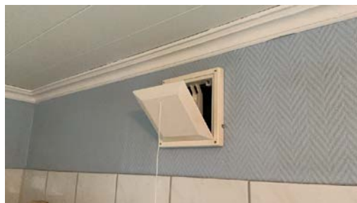
Veggventilen er koblet til elektrisk styrt vifte.
