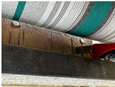
Råteskade i kledning
