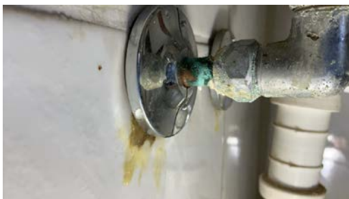
irr på rør
