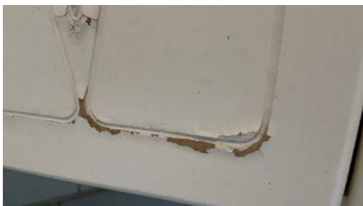
Fuktskader på skapdører
