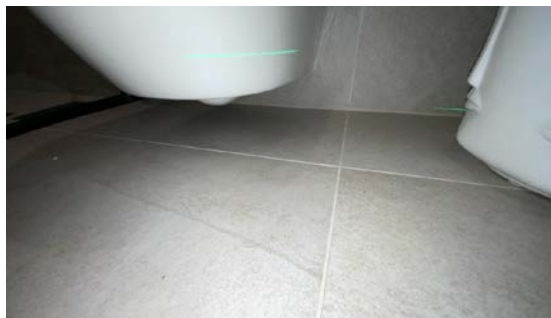
Lekkasjespalte på innebygget sistene bør opparbeides.
