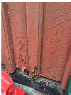
Råte i kledningsbord utenfor soverom.
