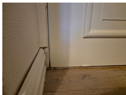
Utett mellom dør og karm, samt skade i bunn.
