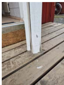
Sveller i bunn av felles ytterdør.
