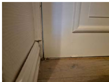
Utett mellom dør og karm, samt skade i bunn.
