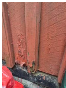
Råte i kledningsbord utenfor soverom.
