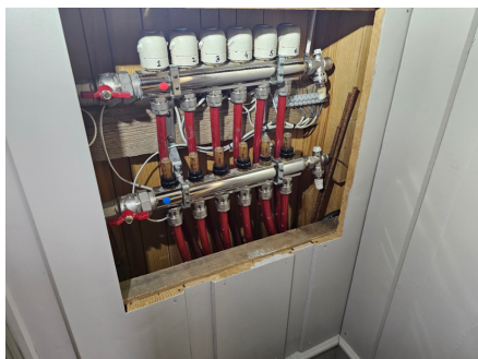
Fordelingsskap til vannbåren varme.
