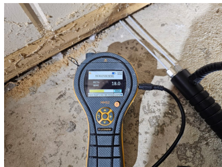
Målt ca 18 % fukt i svilla.
