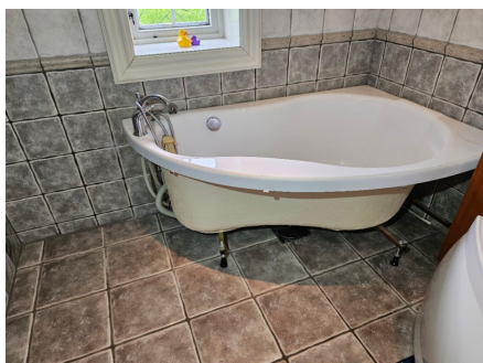
Vindu over badekar er utsatt for vannsøl.
