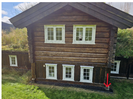
Markering viser hjørnet med fukt i bunnstokk.
