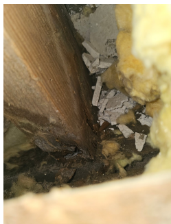
Svertesopp på treverk inne i vegg.
