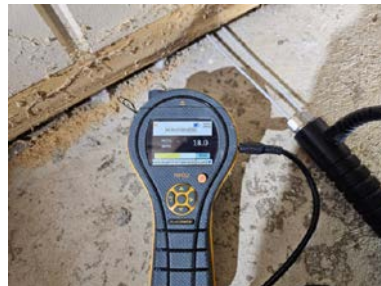
Målt ca 18 % fukt i svilla.
