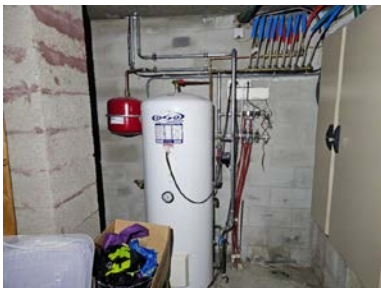
Bereder til golvvarme og forbruksvann.
