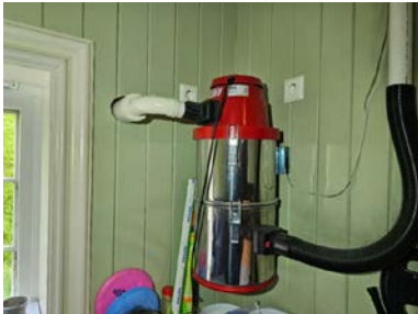
Støvsuger i vaskerommet.
