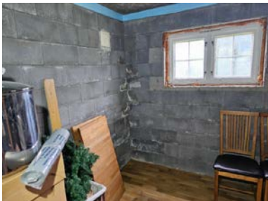
Noe saltutslag uten betydning i et rom.
