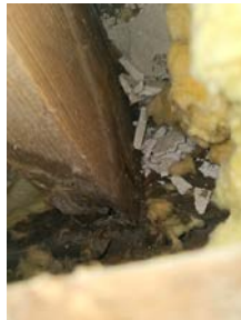
Svertesopp på treverk inne i vegg.
