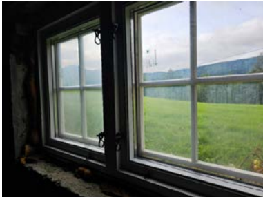
Punktert vindu i kjeller
