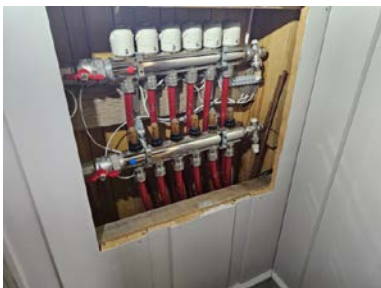
Fordelingsskap til vannbåren varme.
