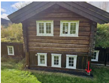
Markering viser hjørnet med fukt i bunnstokk.
