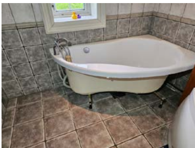
Vindu over badekar er utsatt for vannsøl.
