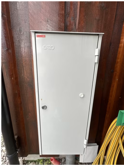
Viser utvendig inntaksskap med måler.
