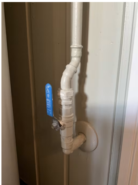
Viser hovedstoppekran på bad.
