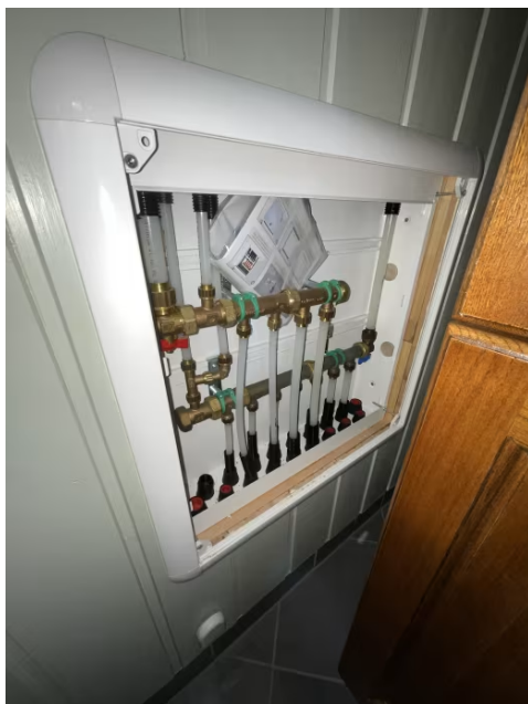
Vannrør med rør i rør system fra fordelerskap plassert på bad og frem til sanitærinstallasjoner på baderom, toalettrom og kjøkken.
