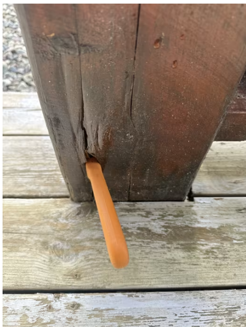
Det registreres råteskader rekkverk.
