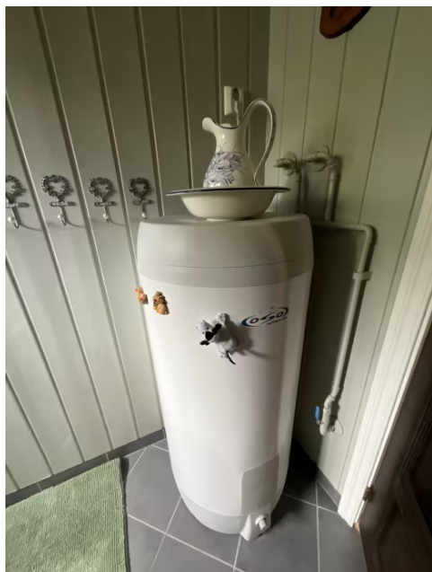
Viser bereder plassert på bad.
