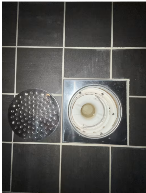
Det registreres at membran ikke er ført inn under klemring. Enkelte utettheter ved klemring.
