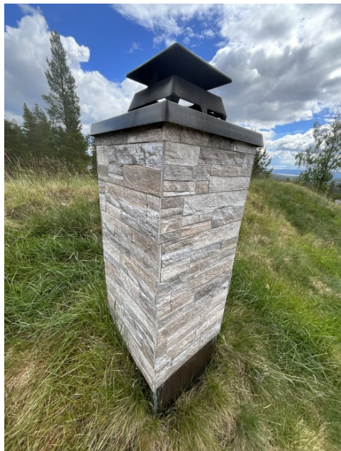
Viser pipe over tak.
