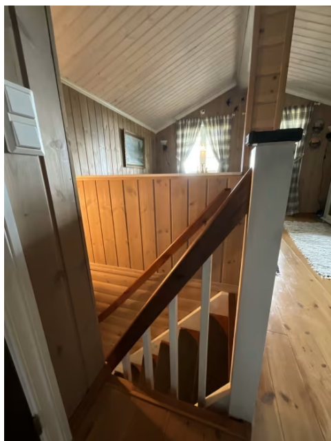
Løsning ved rekkverket i 2.etasje må utbedres, utgjør en risiko for små barn og dyr.
