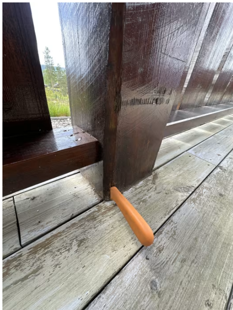
Det registreres råteskader rekkverk.
