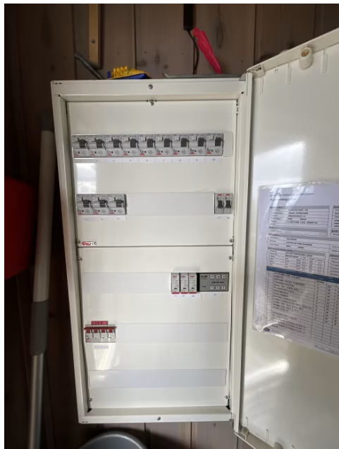
Viser innfelt sikringskap plassert i bod.
