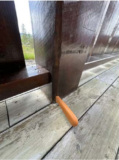
Det registreres råteskader rekkverk.
