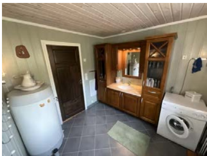
Viser installasjoner på våtrommet.
