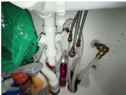
Viser vann og avløpsinstallasjoner under kum.
