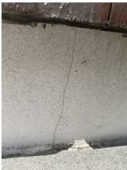
Det registreres mindre sprekker grunnmursplater.
