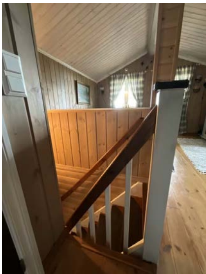
Løsning ved rekkverket i 2.etasje må utbedres, utgjør en risiko for små barn og dyr.
