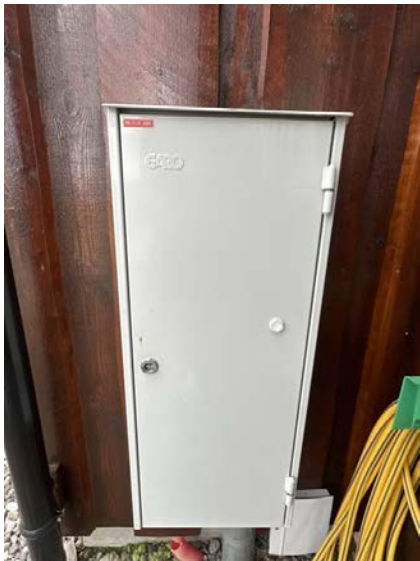
Viser utvendig inntaksskap med måler.
