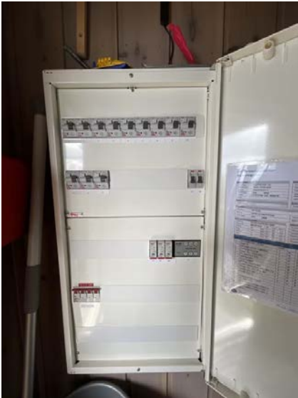
Viser innfelt sikringskapp plassert i bod.
