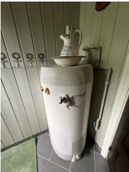
Viser bereder plassert på bad.
