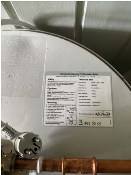
Viser støpsel og teknisk data på bereder.
