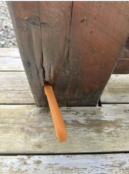
Det registreres råteskader rekkverk.
