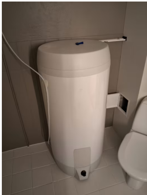
Varmtvannsbereider er plassert på bad i kjeller.
