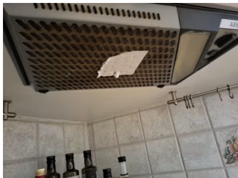
Avtrekkseffekten er testet med papir.
