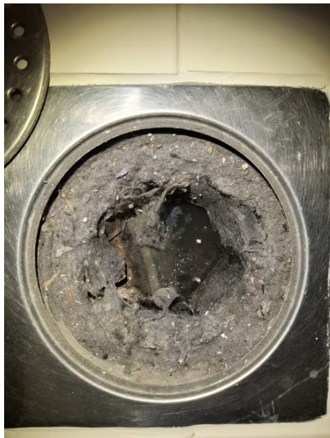
Ingen synlig membran mot sluk.
