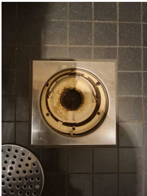
Det ble ikke registrert avvik i overgang mellom sluk og membran.
