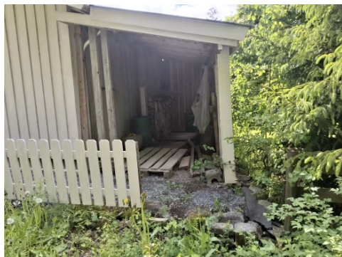
Det registreres skjevheter i vedskjul.
