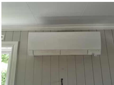
Varmepumpe plassert i stue.
