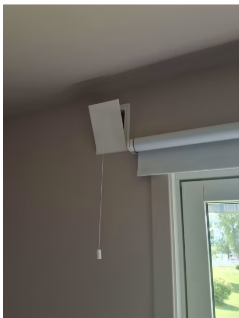
Boligen har naturlig ventilasjon med klaffventiler.
