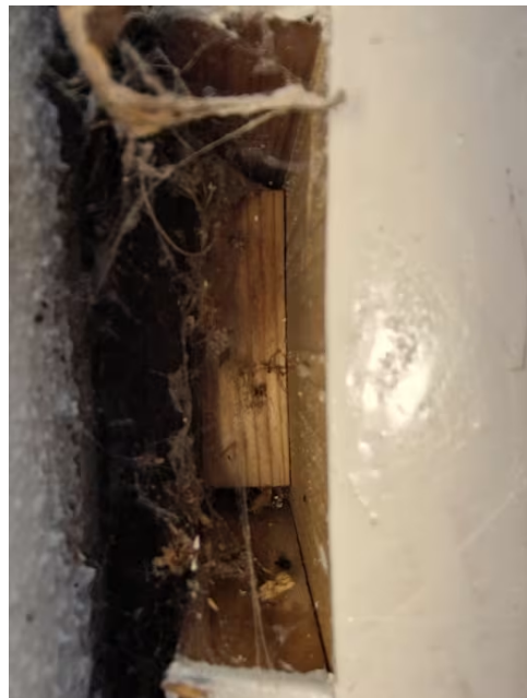
Kledningen tett med klosser.
