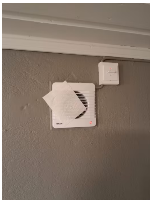
Avtrekkseffekten er testet med papir.
