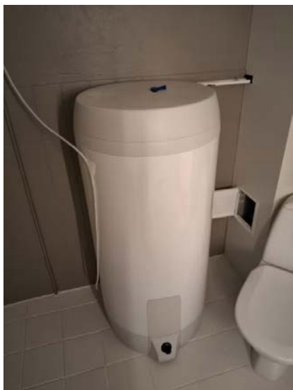
Varmtvannsbereder er plassert på bad i kjeller.
