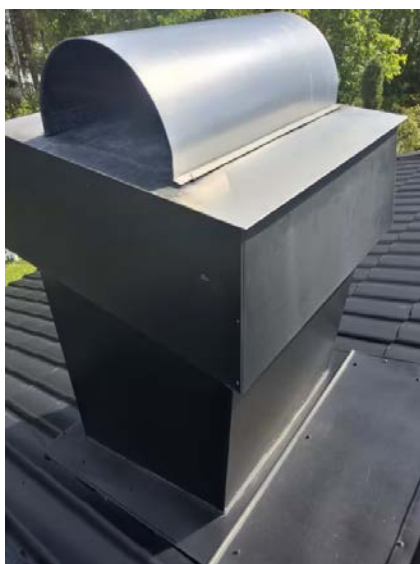
Pipen er beslått med heldekkende pipebeslag.
