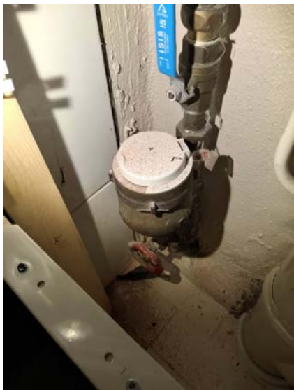
Hovedstoppekran er plassert i kasse på bad i kjelleretasje.
