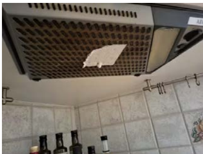
Avtrekkseffekten er testet med papir.
