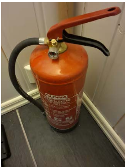
Brannslukningsapparatet ble sist kontrollert i 2007.
