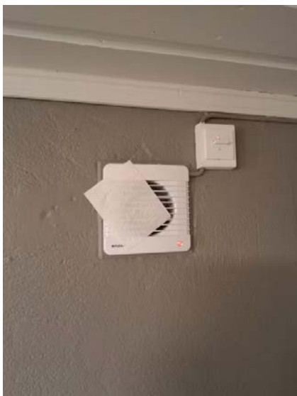
Avtrekkseffekten er testet med papir.
