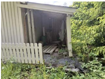
Det registreres skjevheter i vedskjul.
