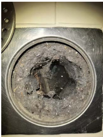
Ingen synlig membran mot sluk.
