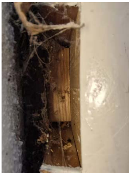
Kledningen tett med klosser.
