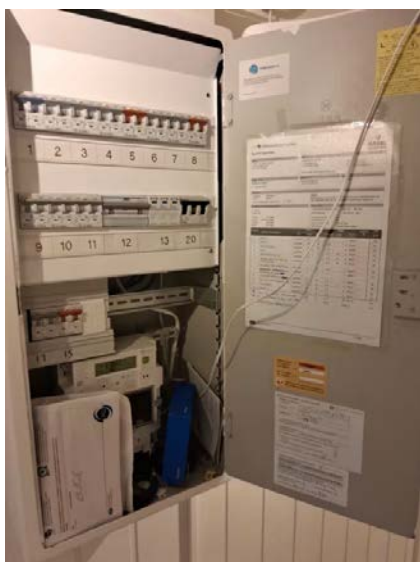
Sikringsskap er plassert i gang i kjeller.
