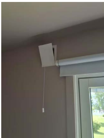
Boligen har naturlig ventilasjon med klaffventiler.
