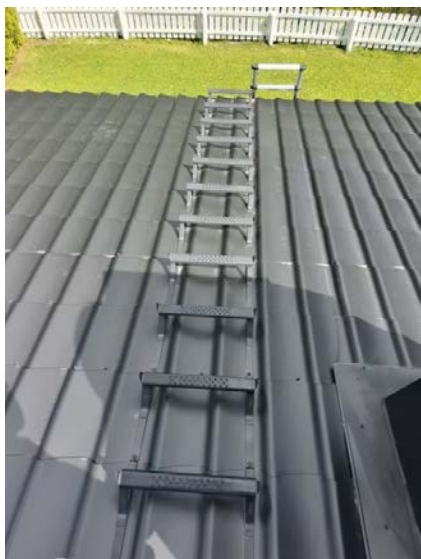
Detner etablert takstige til pipe.
