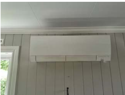
Varmepumpe plassert i stue.
