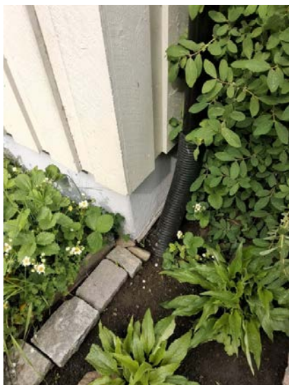
Taknedløp er ført ned i drensrør.
