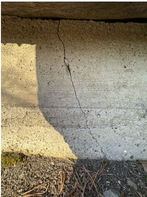
Det er registrert mindre skråriss som er symptom på setninger.
