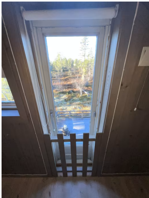
Viser dør for bruk til rømning fra 2.etasje.
