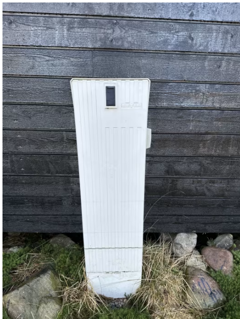
Viser utvendig målerskap.
