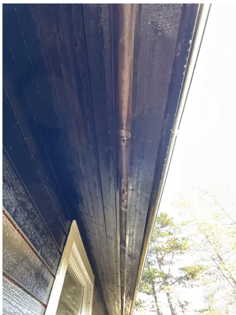
Det registreres hull i fluenetting ved raft.
