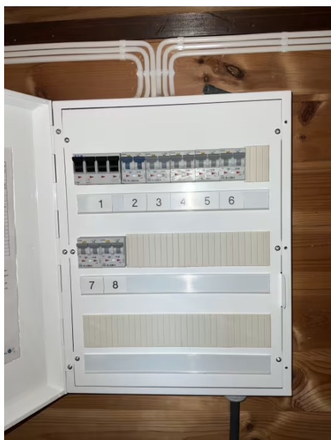
Viser sikringskap plassert i bod.
