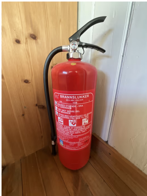
Viser brannslukningsapparat over 10 år.
