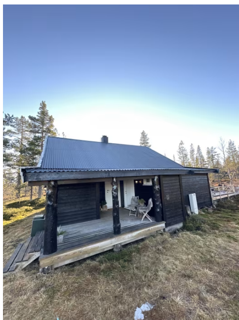
Det mangler takrenner på deler av taket.
