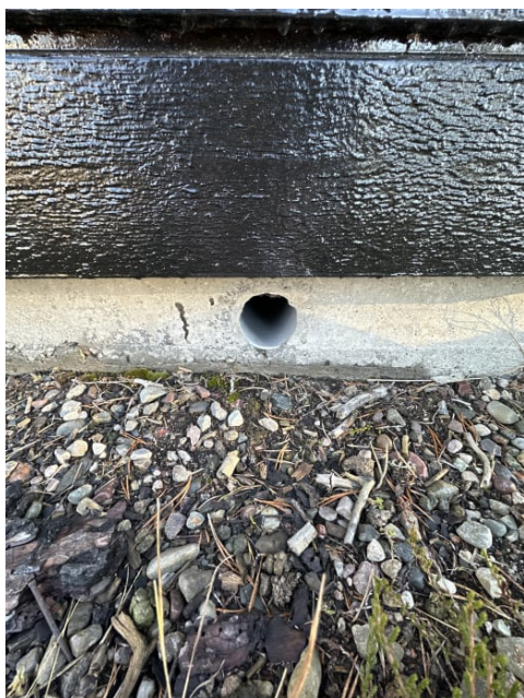
Det registreres lufferør i ringmur. Det er ikke etablert netting i luker. Netting etablert i luker anbefales.
