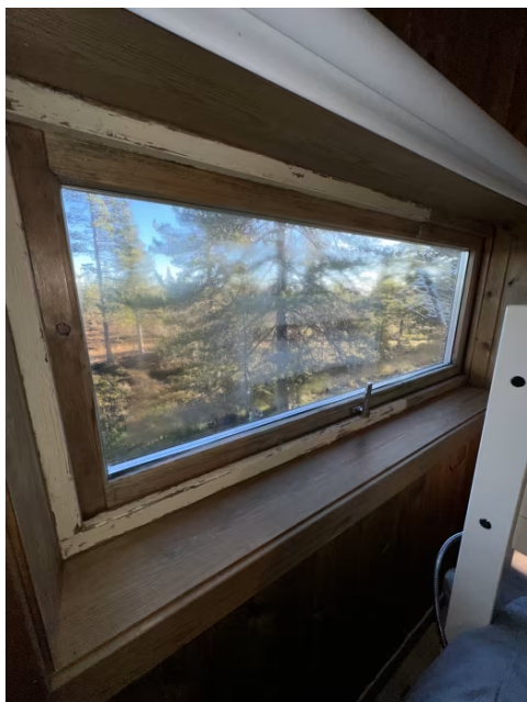
Viser slitasje og punktert vindu i 2.etasje
