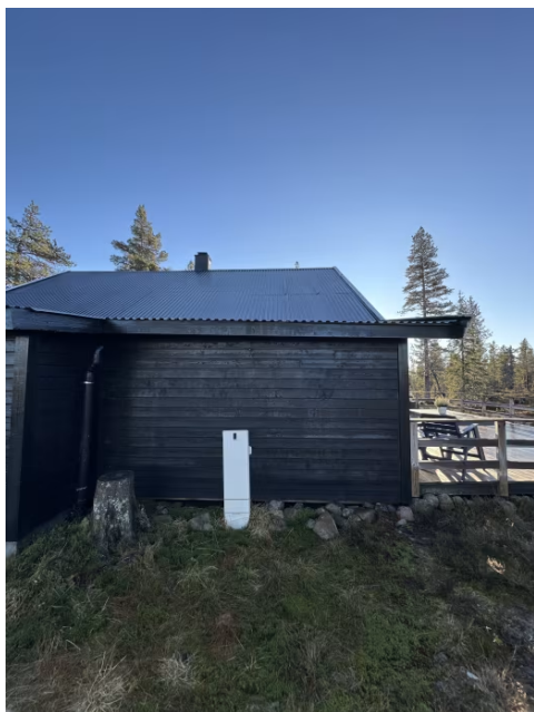
Det registreres skjevhet ved takkonstruksjon.
