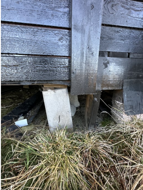
Det registreres skjevhet ved fundament.
