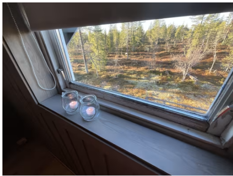
Viser slitasje og punktert vindu i 2.etasje
