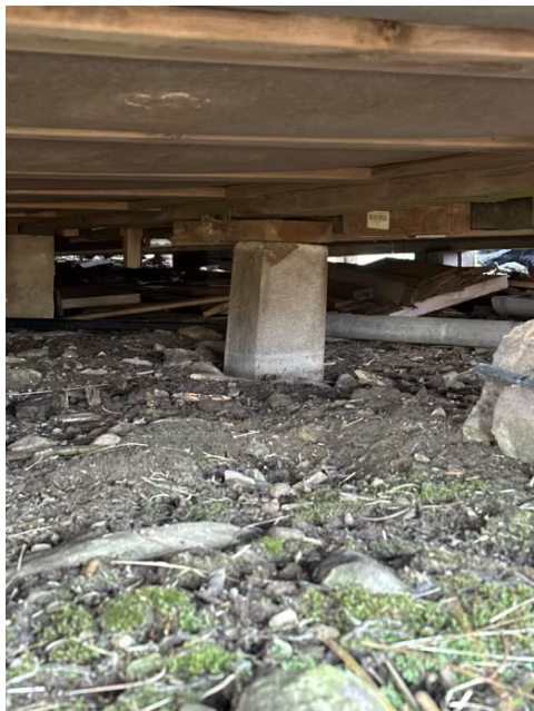
Det registreres skjevhet ved fundament.
