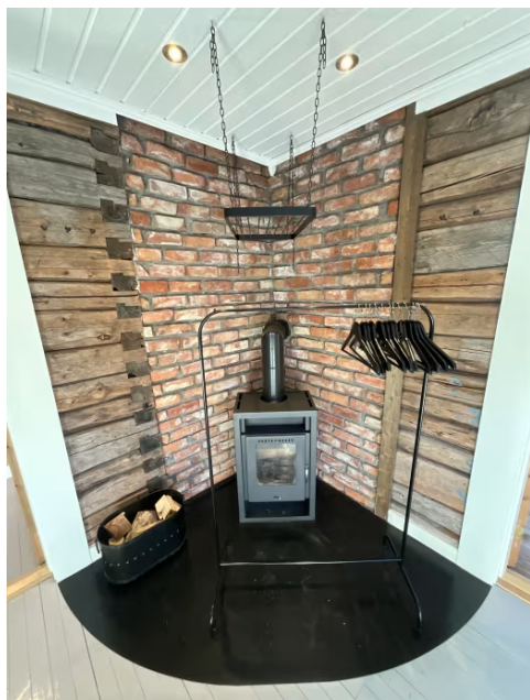
Viser ildsted på kjøkken.
