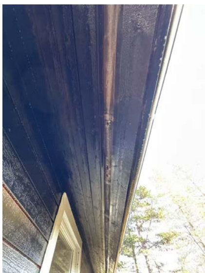
Det registreres hull i fluening ved raft.
