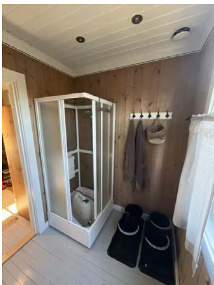
Viser dusjkabinett med fotpumpe avløp ført til grunnen.
