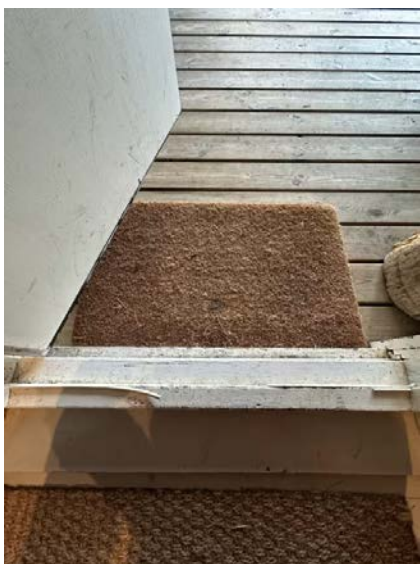
Det registreres harde, defekte tettelister på vinduer og dører som pga dette tetter dårlig.
