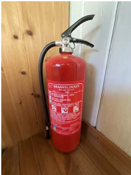
Viser brannslukningsapparat over 10 år.
