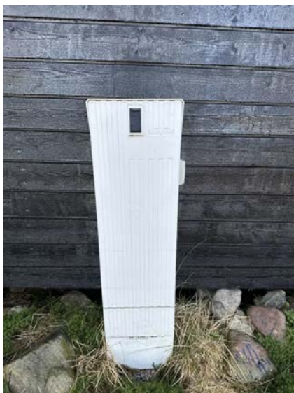
Viser utvendig målerskap.
