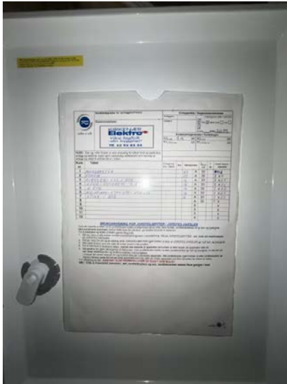
Viser kursfortegnelse i sikringskap.
