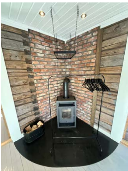
Viser ildsted på kjøkken.
