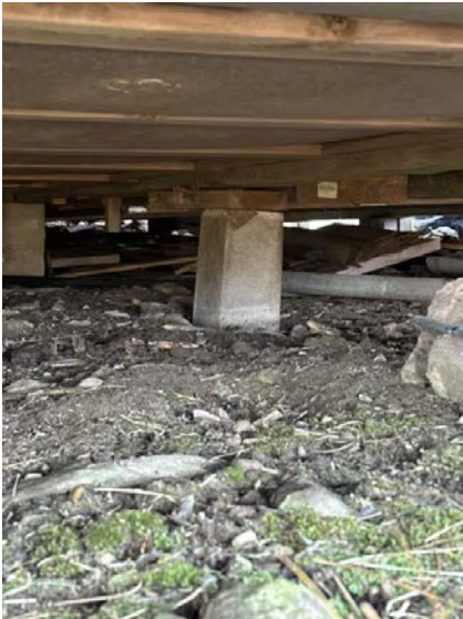
Det registreres skjevhet ved fundament.
