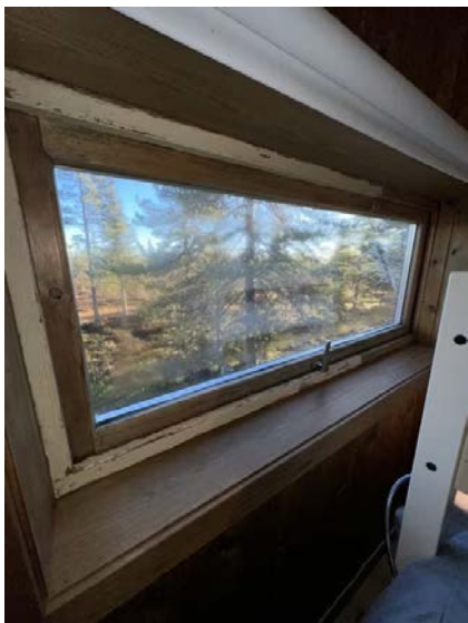
Viser slitasje og punktert vindu i 2.etasje
