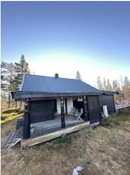
Det mangler takrenner på deler av taket.
