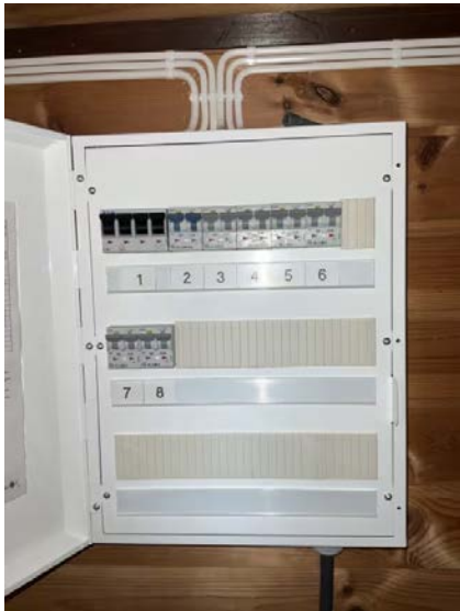
Viser sikringskap plassert i bod.
