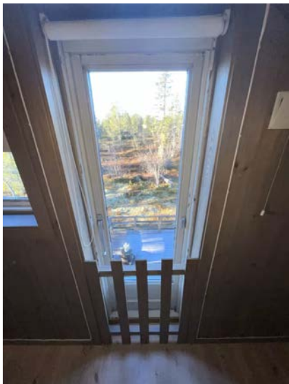
Viser dør for bruk til rømning fra 2.etasje. Rekkverket er skrudd, det må etableres en bedre løsning for å unngå klatring ved rømning. Det anbefales at rekkverket hengsles. Balkong/platå utenfor dør anbefales etablert.
