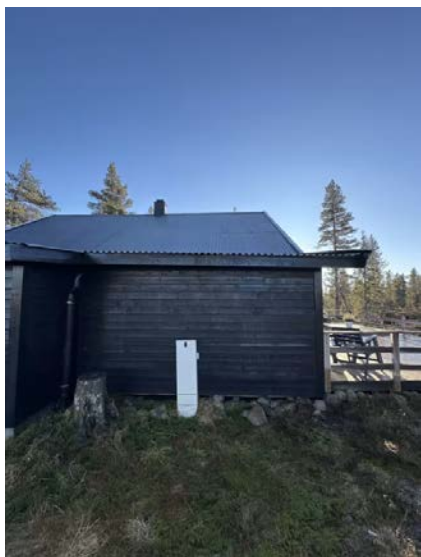
Det registreres skjevhet ved takkonstruksjon.
