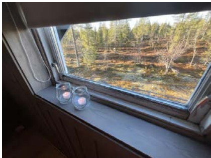
Viser slitasje og punktert vindu i 2.etasje
