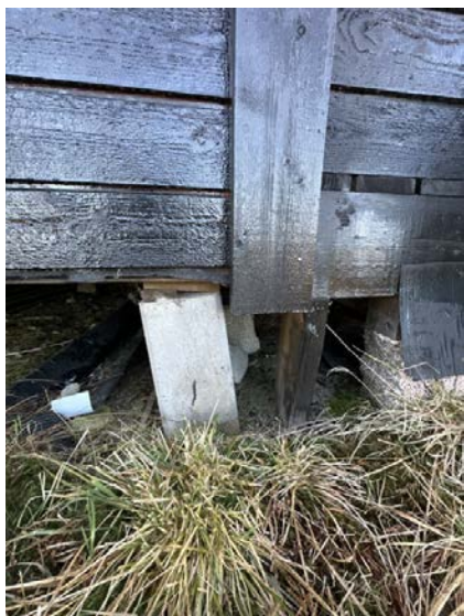
Det registreres skjevhet ved fundament.
