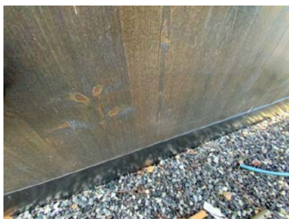
Minimalt med lufting av kledning uten dryppspalte i bunn.
