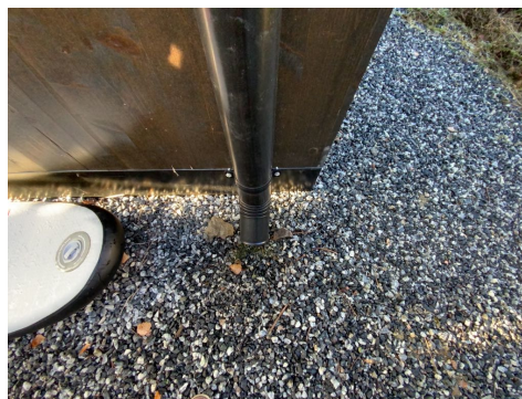
Nedløpsrør bør føres bort fra boligen.
