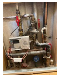
Stoppekran plassert på innredet rom i U.etg.
