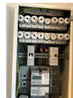
Sikringsskap med automatsikringer.
