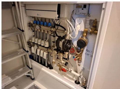
Sentral for vannbåren gulvvarme er plassert i bod/teknisk rom.
