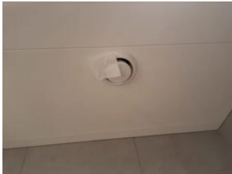
Avtrekkseffekt er testet med papir.
