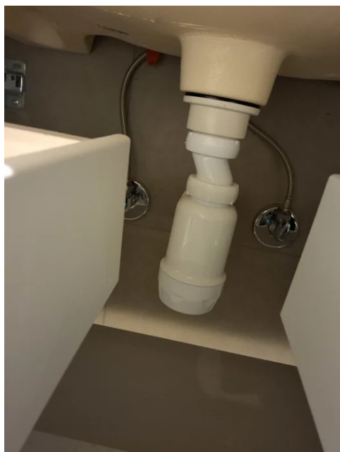
Leiligheten har synlige avløpsrør av plast.
