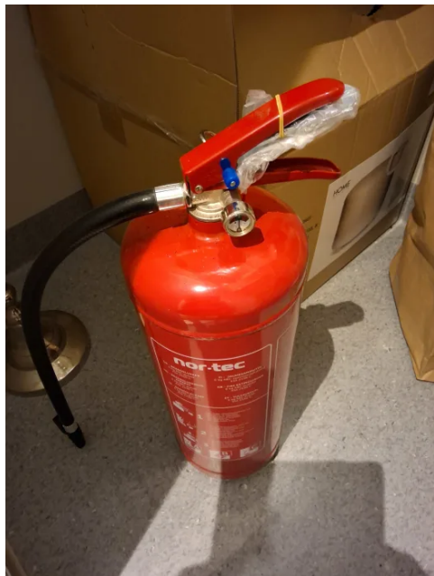
Brannslukningsapparat er plassert i bod/teknisk rom.
