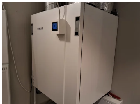
Ventilasjonsaggregat er plassert i bod/teknisk rom.
