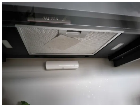
Avtrekkseffekt er testet med papir.
