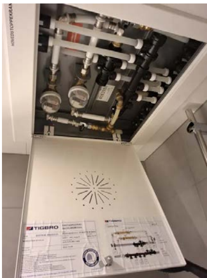
Fordelerskap med stoppekraner er plassert i himling på bad.
