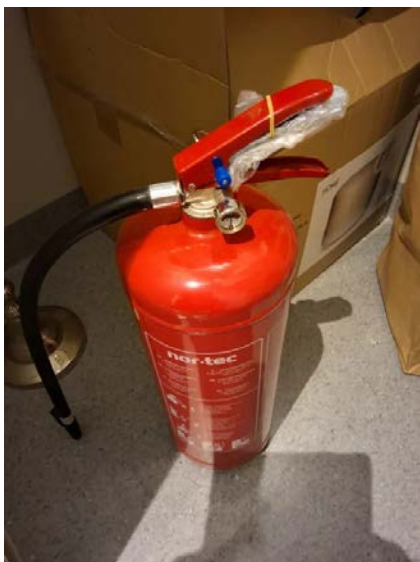
Brannslukningsapparat er plassert i bod/teknisk rom.
