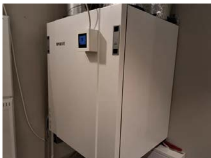
Ventilasjonsaggregat er plassert i bod/teknisk rom.
