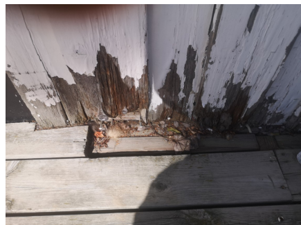
Råte i kledning og trolig i bunnsvill.
