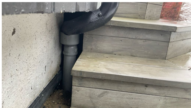
Nedløp tilkoblet overvannsrør under bakkenivå.
