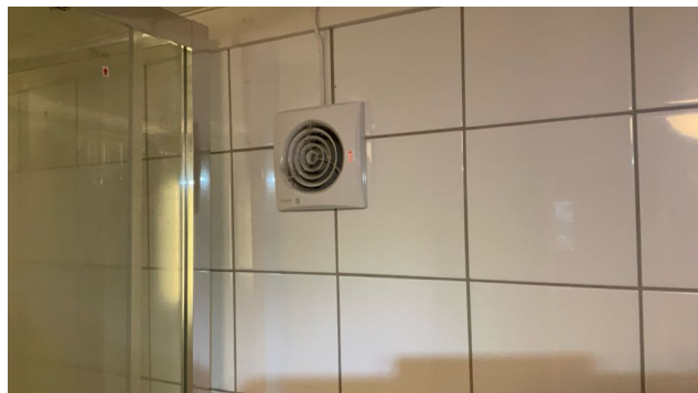
Avtrekk ut gjennom vegg.
