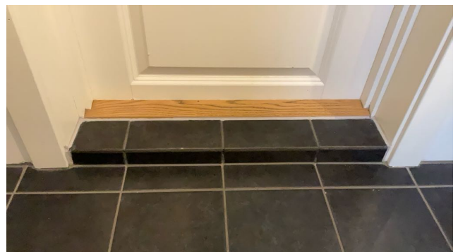
Manglende tilluft til våtrommet.
