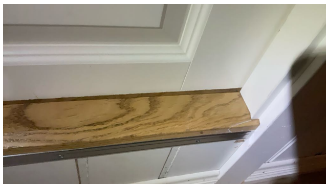
Tilluft under dør
