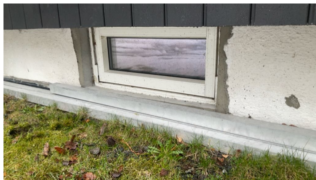
Manglende beslag under vinduer.
