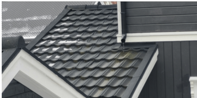
Skader på takplater på garasje.
