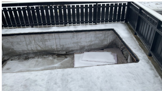
Utsparring i terrasse mangler rekkverk.
