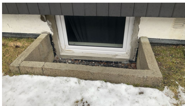
For liten høyde fra terreng til kjellervindu.
